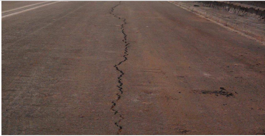
Figure 13 : Fissure de la chaussée
