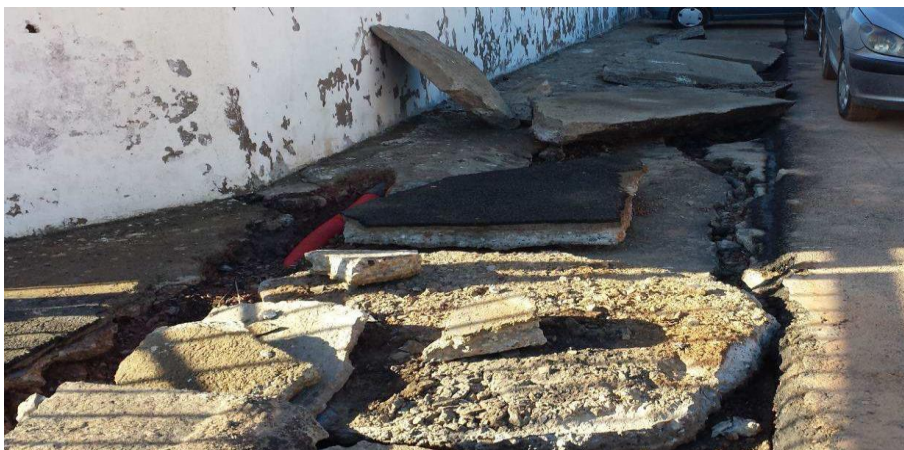
Figure 11 : Décollement du revêtement en béton
