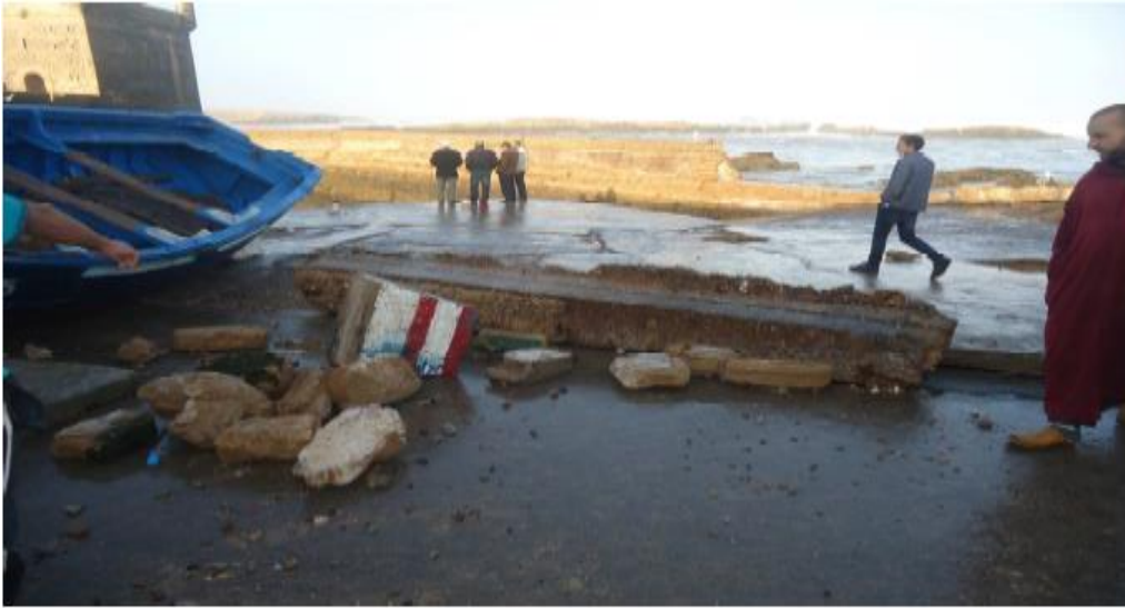
Figure 21: Arrachement d'un tronçon du mur de garde
