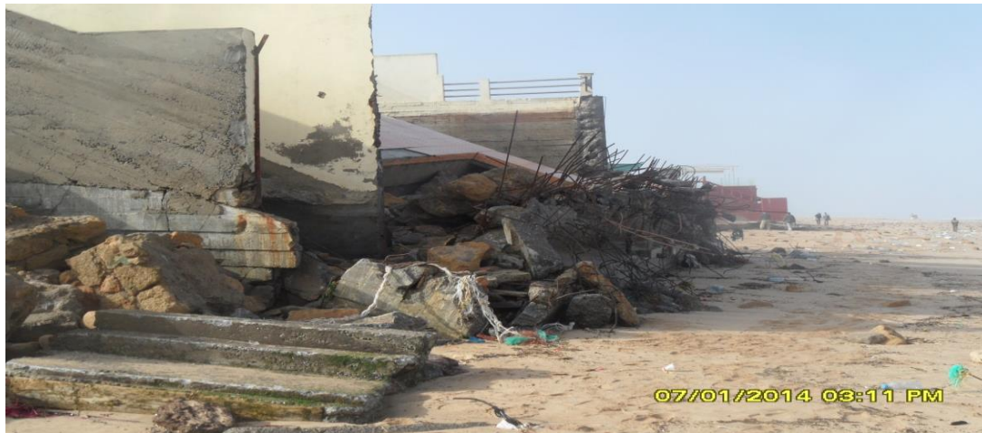
Figure 26 : Mur de clôture de la construction C.N.S.S endommagé
