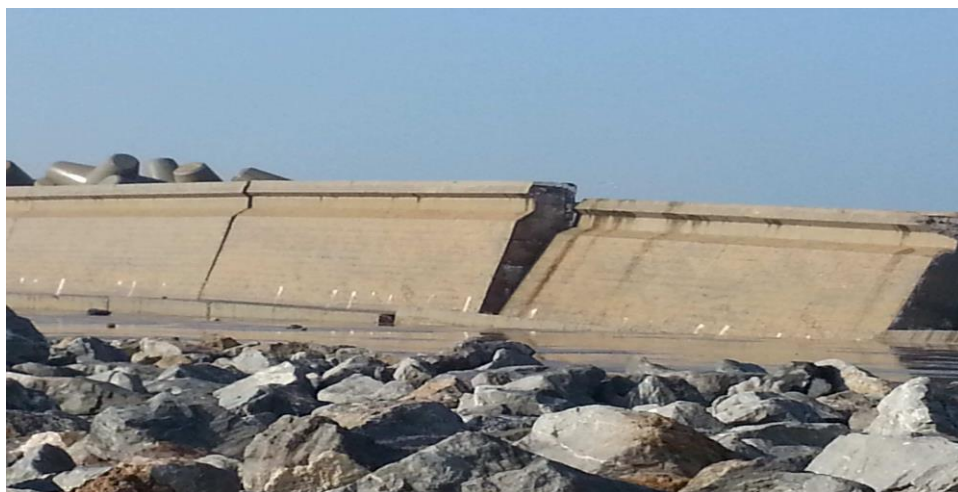
Figure 8 : Blocs du mur de garde inclinés
