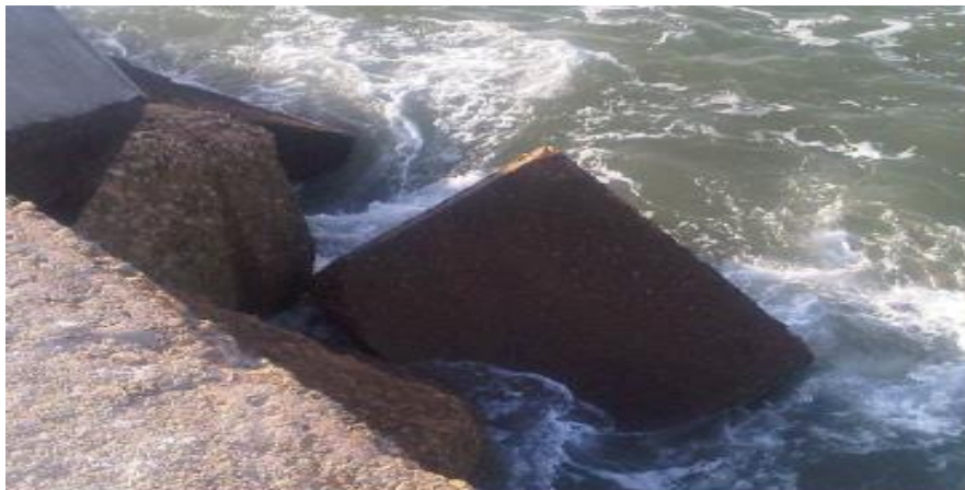
Figure 19: Effondrement du talus en enrochement
