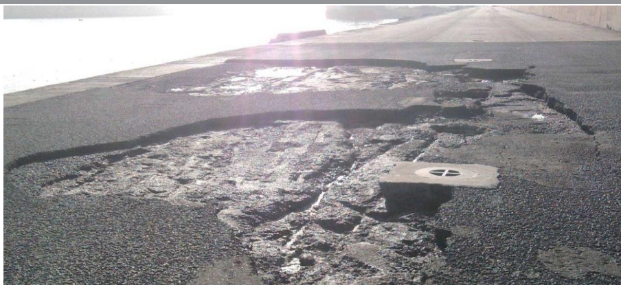
Figure 10 : Décollement du revêtement en enrobés de la voie de circulation
