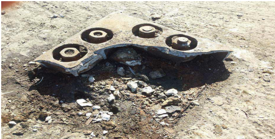
Figure 14 : Bollard en acier arraché
