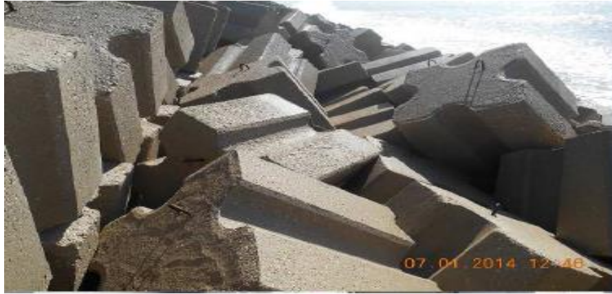
Figure 23: Désordres au niveau de quelques blocs du musoir
