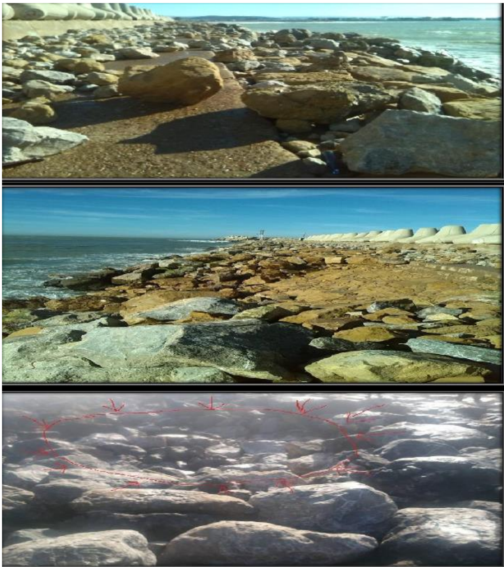
Figure 15 : Dégâts causés au niveau des ouvrages de protection et d'accostage
