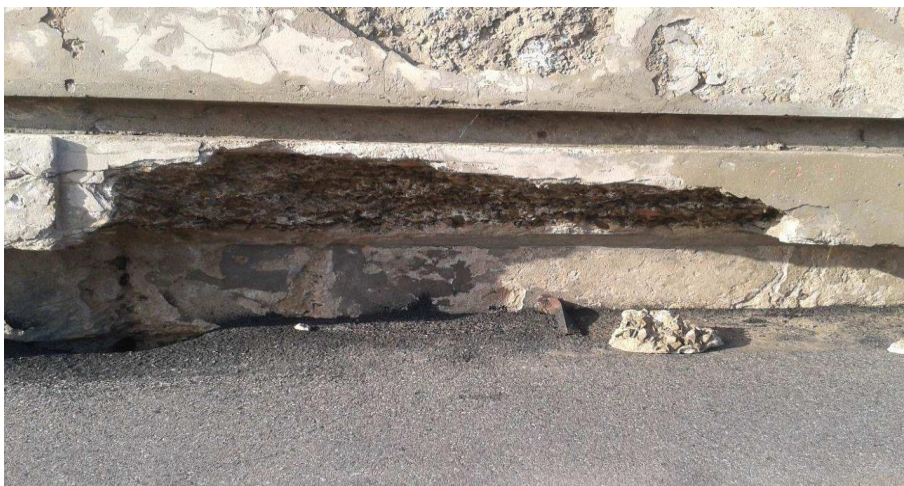
Figure 12 : Dégradation du mur de garde
